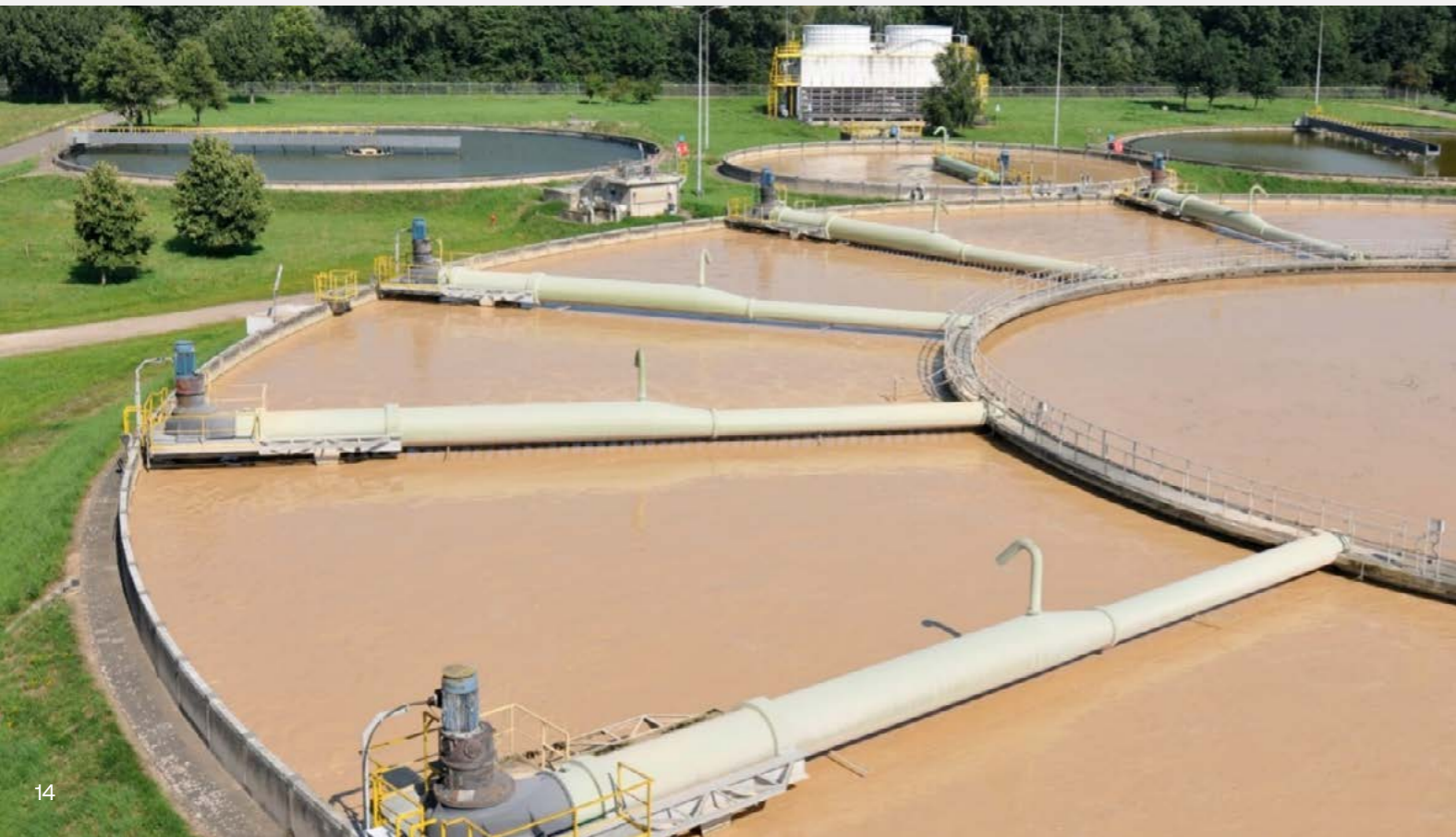
Figuur 4 Integrale Afvalwater Zuivering Installatie (IAZI)
